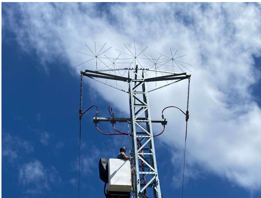
Fotos. Apoyo metálico y sus elementos.
