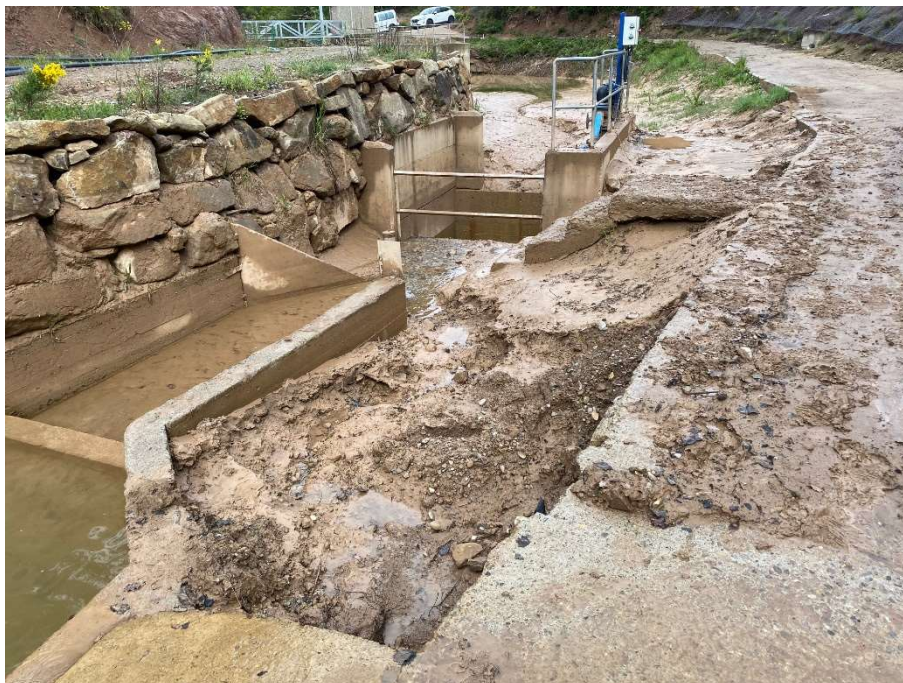
Foto. Estado desarenador y pozo de captación 06/05/2024.
