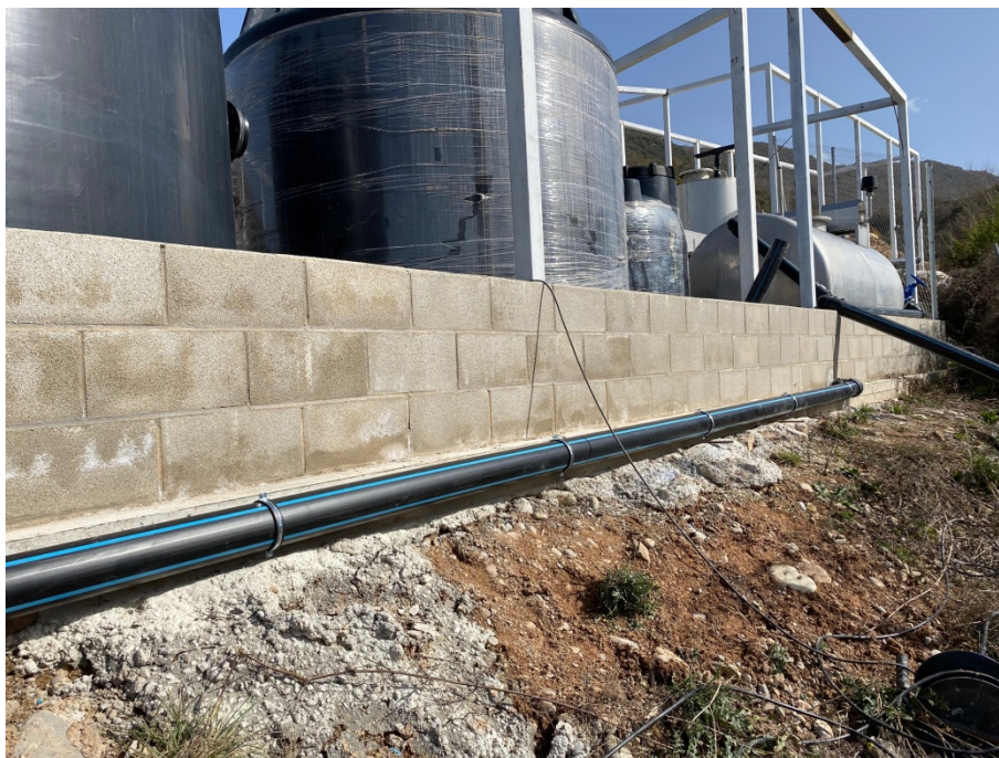
Foto. Desagüe plataforma inferior LIFE.
