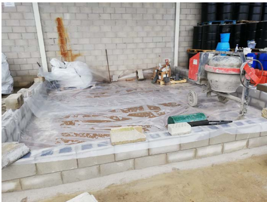
Foto. Cubeto de bloque en planta de transferencia de Bailín.
