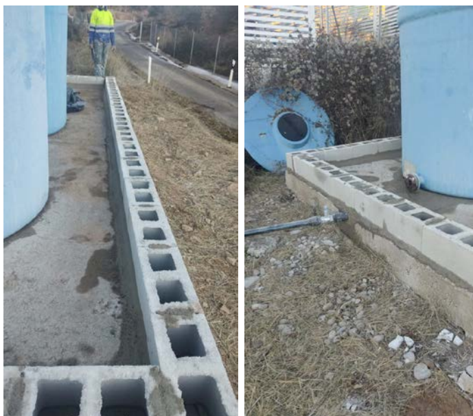
Foto. Cubeto perimetral depósitos con carbón activo.
