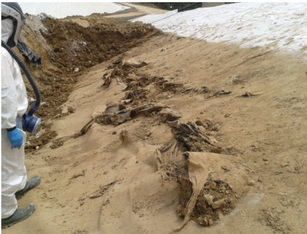
Figura. Rotura paquete de impermeabilización, año 2014.
